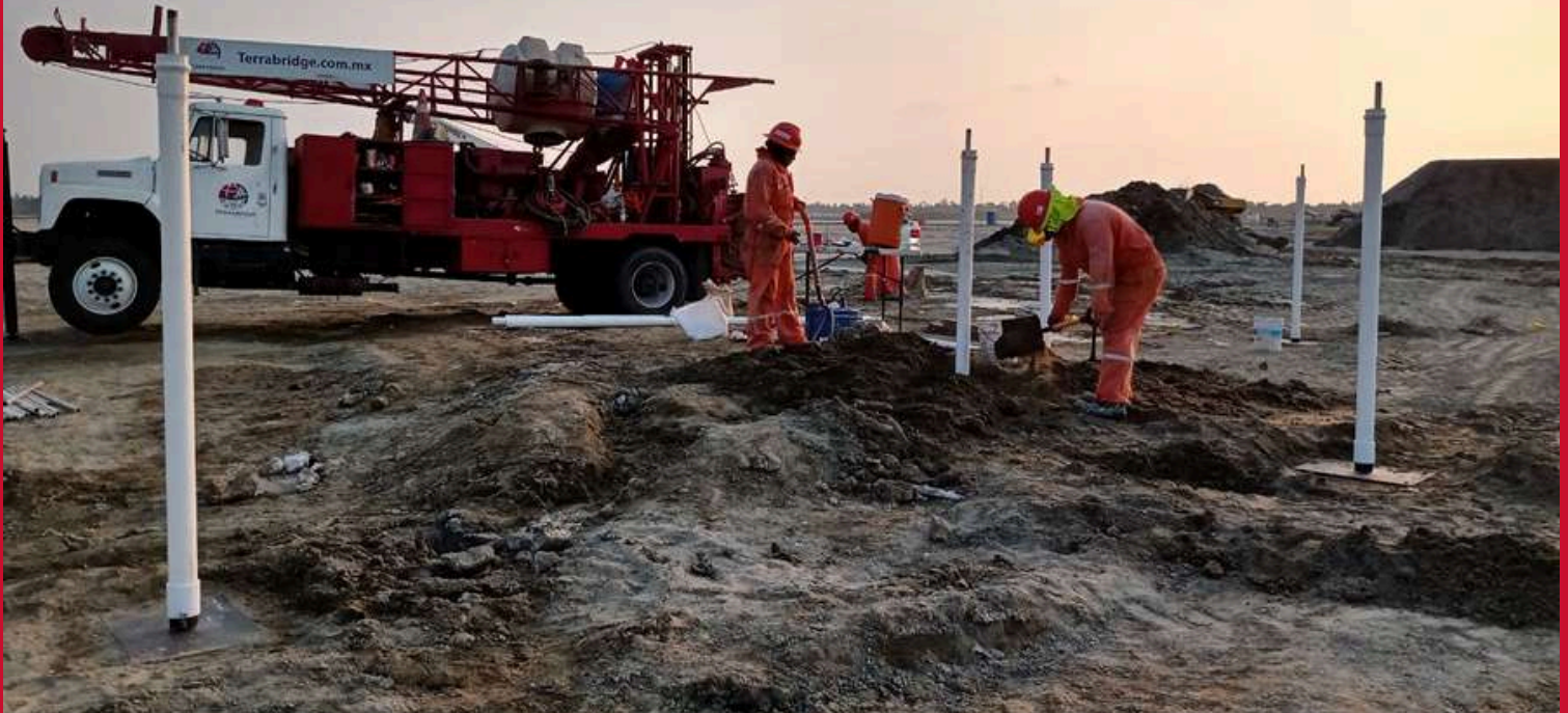
1.- NUEVA REFINERÍA 2 BOCAS, PARAÍSO, TABASCO
